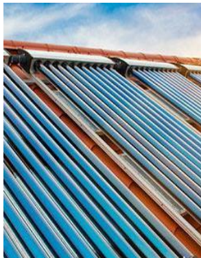
Paneles solares térmicos
