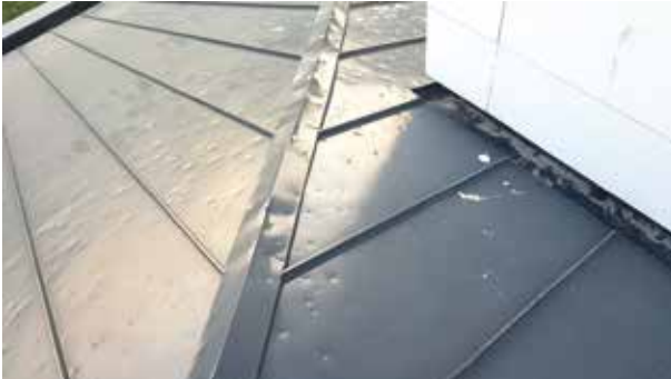
Metal Esaslı Çatı Kaplama Malzemesi ve Dolu Yağışı Etkisi
